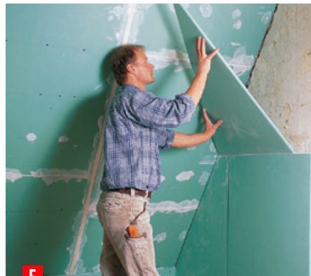
5 Направление работы — снизу вверх. При этом прижмите друг к другу края, имеющие для стыковки закрочки или с фасками. Сместите горизонтальные стыки плит (уложите вразбежку) и избегайте перекрещивающихся швов.
